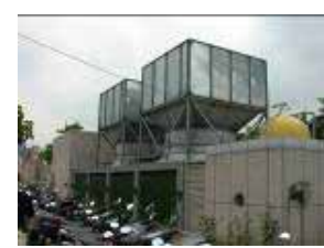
冷卻水塔設置消音箱
