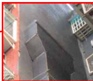
出風口設置消音箱
