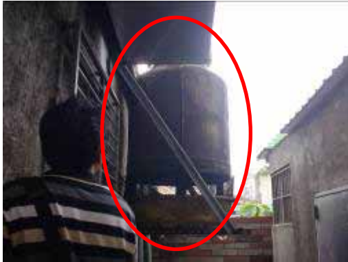
設置於後巷之老舊冷卻水塔
