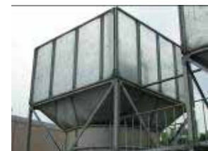
冷卻水塔設置消音箱
